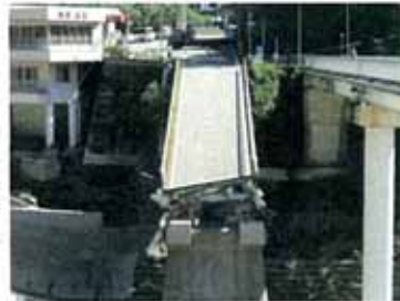
（A1～P1 鋼鈑桁橋の落橋状況）
