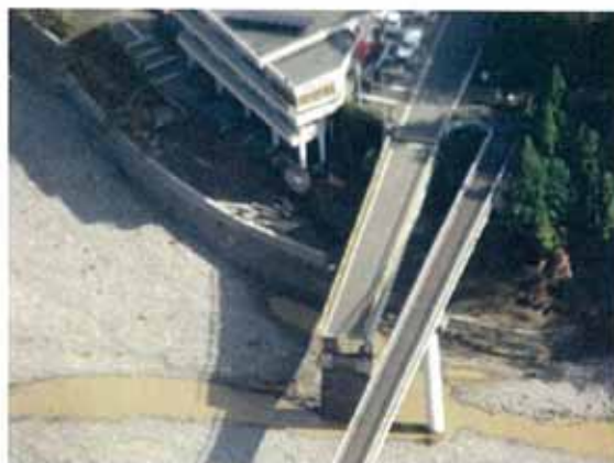
新宮側の落橋区間
