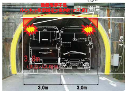
〔南側坑口(上北山村)〕 建築限界未確保
