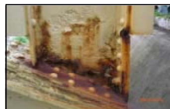
橋梁の腐食による損傷 （国道1号白川橋）
