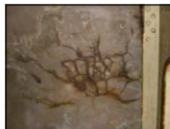
橋梁床版の亀裂 （国道25号名阪国道山添橋）
