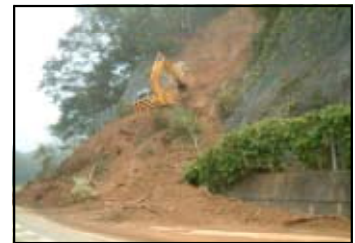
土砂崩落(京都府)
