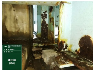
鋼主桁端部の腐食
