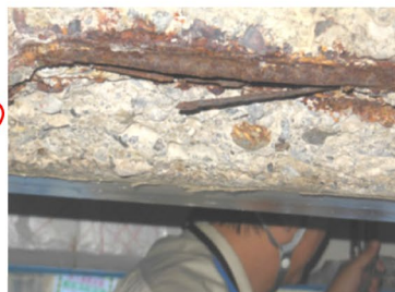
PC鋼線の破断 (塩害)
