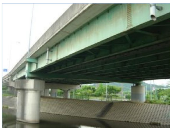
防食機能の劣化
