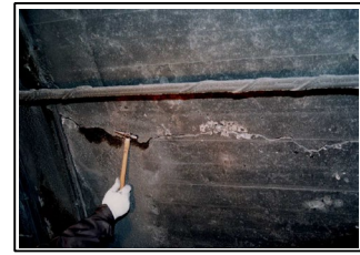
コンクリートの剥離
