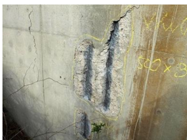
剥離・鉄筋露出
