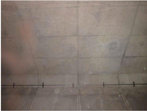
頂板のひび割れ
