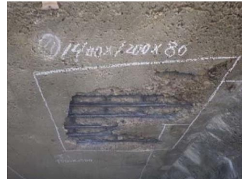
コンクリートが剥離し鉄筋が露出
