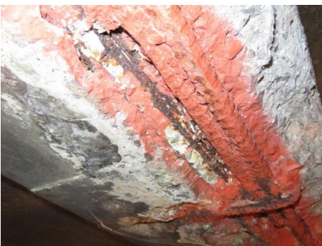
コンクリートが剥離し鉄筋が露出
