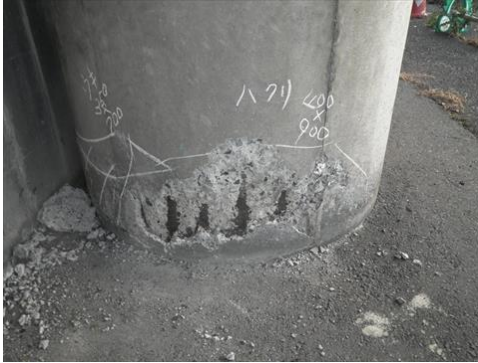
コンクリートが剥離し鉄筋が露出
