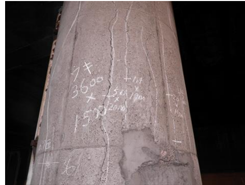
コンクリート表面に浮き
