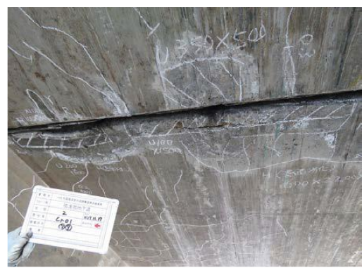
早期に剥落危険箇所を措置
