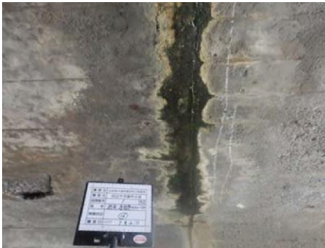
クラックが発生し漏水が見られる
