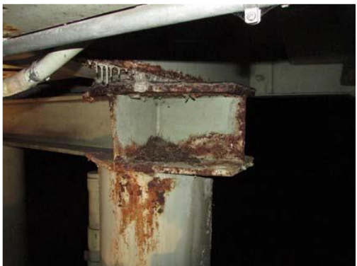
鋼製部材の腐食
