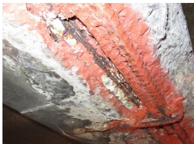
剥離・鉄筋露出
