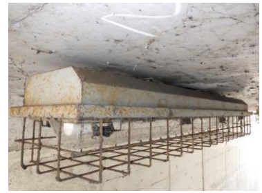
附属物の腐食
