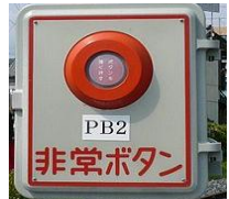
非常押しボタン
