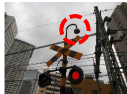
踏切監視用カメラ
