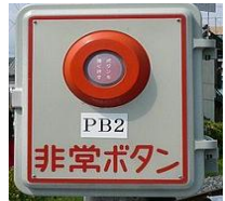
非常押しボタン
