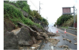
写真1 法面崩落状況（串本町和深地先）
