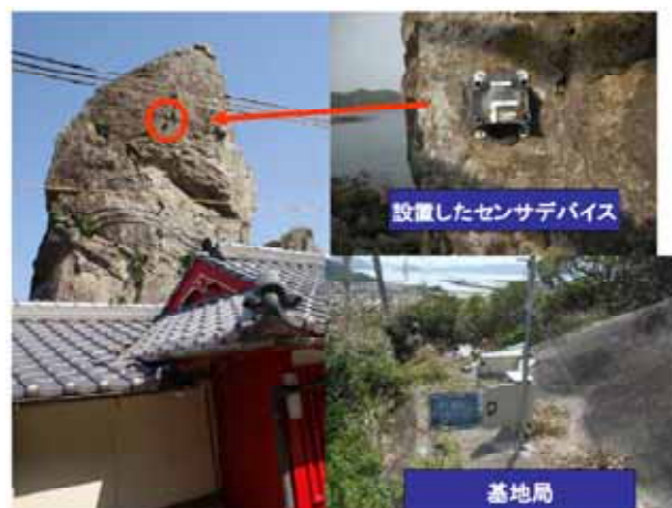
図-3 岩盤崩壊モニタリングシステムの実用例
