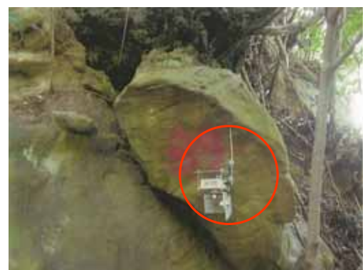
図-7 設置対象箇所の状況（上）と センサデバイス設置状況
