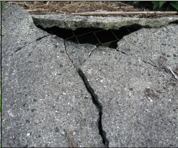
モルタルの剥離
