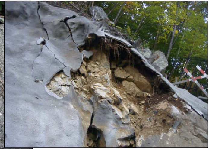
土砂化による崩壊
