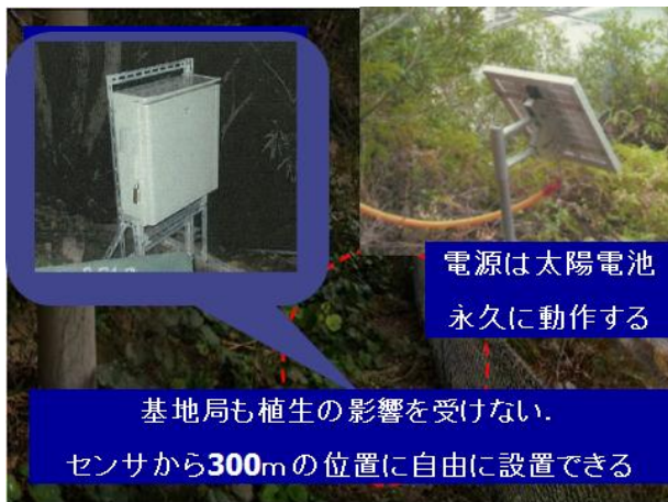
図-9 基地局の設置例
