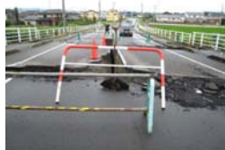
舗装の亀裂・段差・沈下
