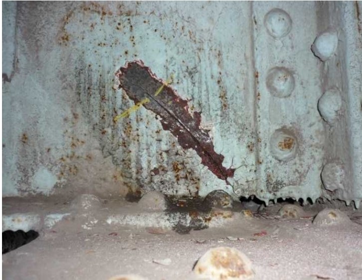
塗膜割れの状況
