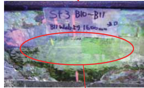
下フランジの磁粉探傷試験
