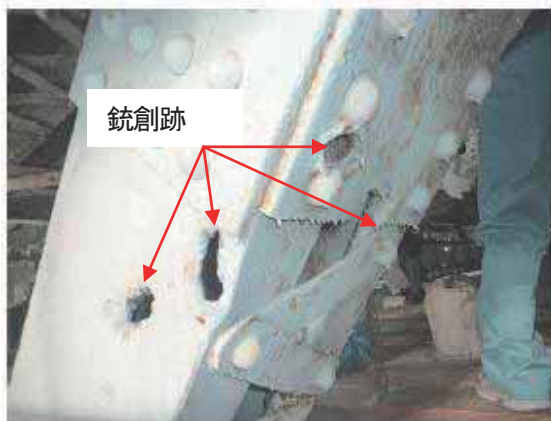
写真1 トラス斜材の銃創跡
