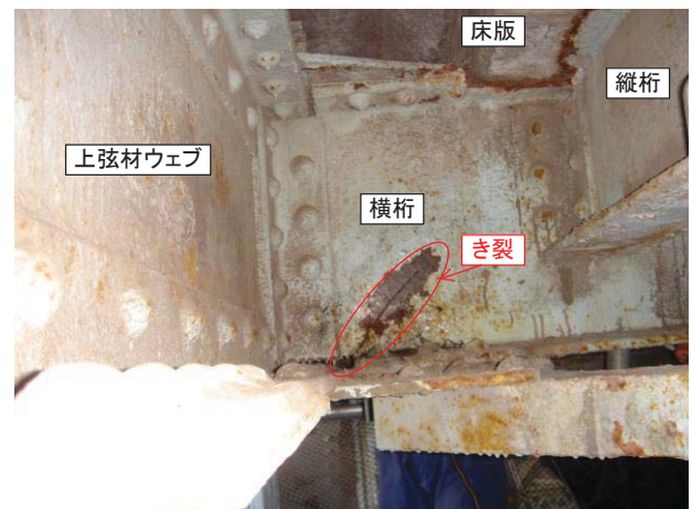
写真1. 実橋の損傷状況
