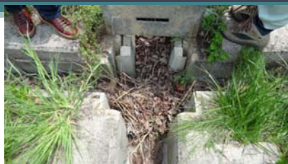
1段目の小段にあるU字溝合流ポイントのマスには大量の落ち葉が堆積している。
