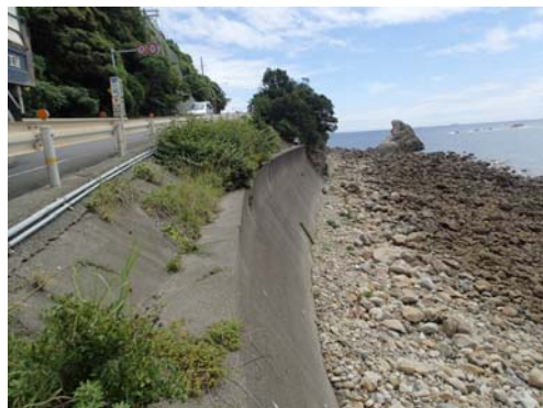
護岸工に押出発生
