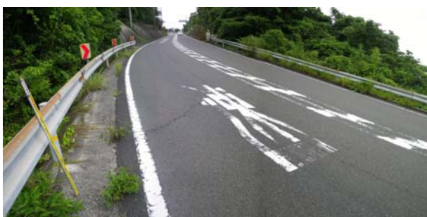
路面に円弧状の亀裂有り
