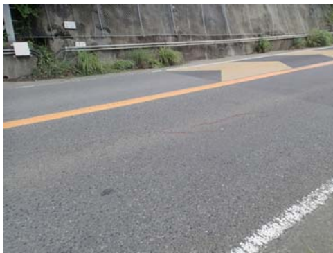
路面に亀裂有り
