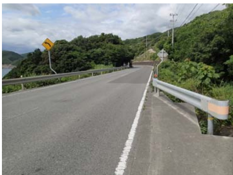
路面に変状無し
