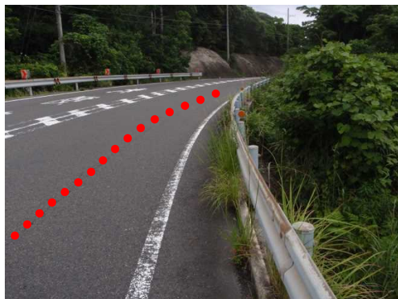
路面に縦断方向へ段差亀裂有り
