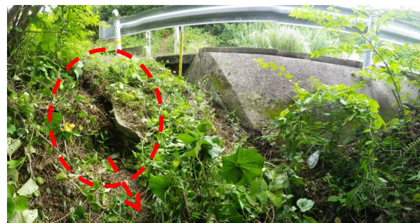
縦排水工裏側の盛土材の流亡
