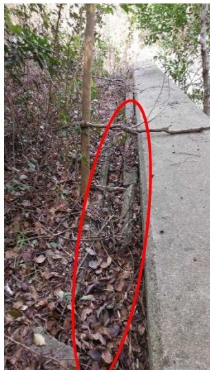
パラペット背面排水溝 の破損
