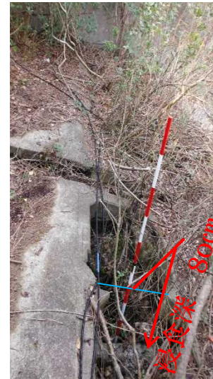
のり枠工空洞化
