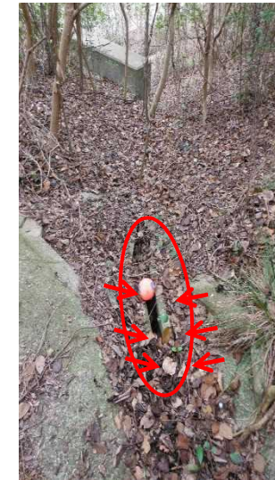
縦排水溝の破損 (圧壊)
