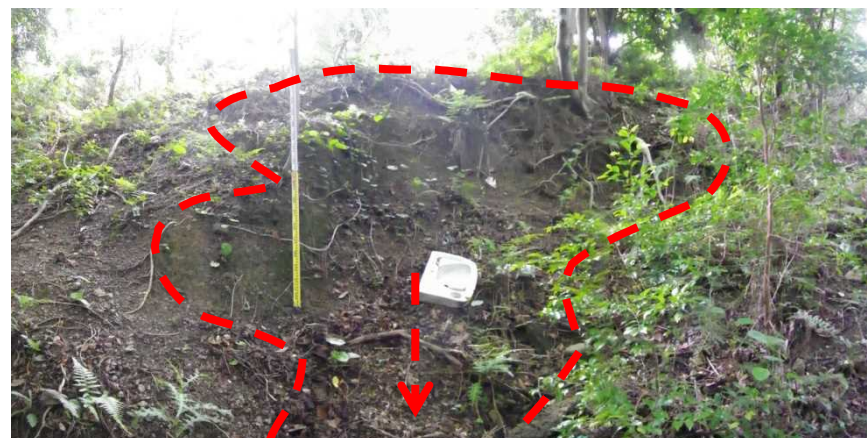
盛土法面に崩壊が発生
