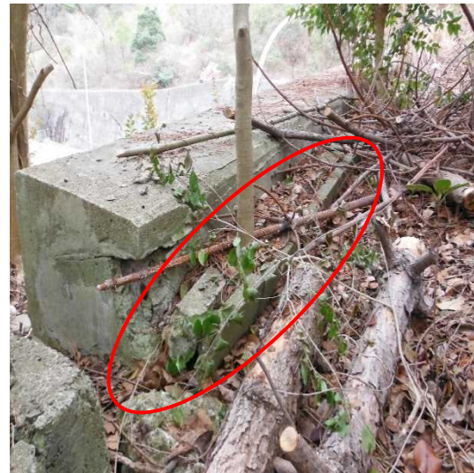
パラペット端部排水溝 の破損
