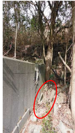
排水施設損壊
