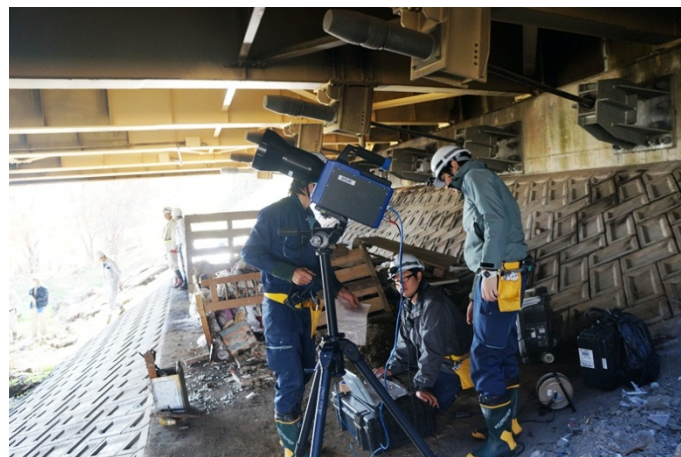
写真－2 機器設置状況
