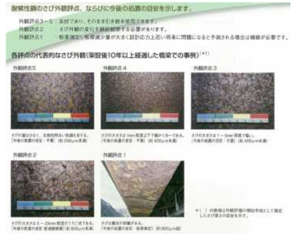
さび外観評点の事例
