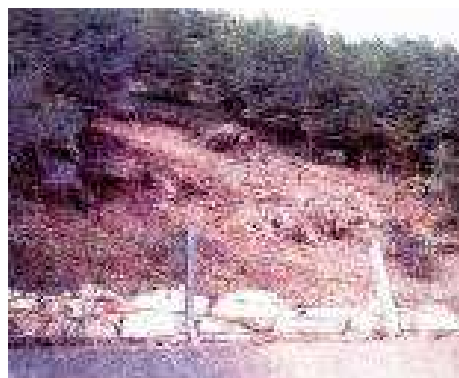
H16年N009A085被災状況
