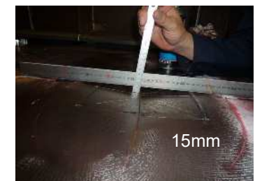
U1デッキ上面陥没深さ
