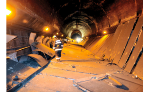
笹子トンネル天井落下事故の様子
