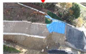
平成30年11月 断層による土砂崩壊
