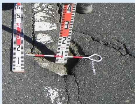
舗装打継ぎ目地部での ポットホール
