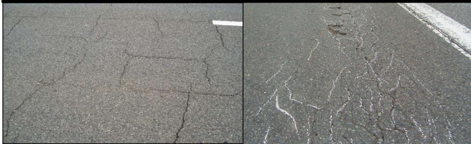
①ひび割れ
