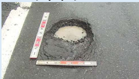
路盤や基層での滞水による ポットホール
