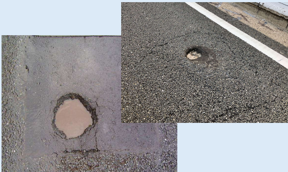
補修跡に生じたポットホール
