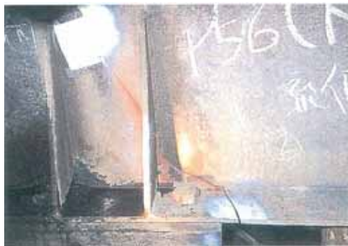
写真-3 支承ソールプレート溶接部付近の亀裂 2)
