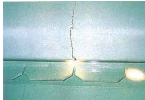
写真-4 縦リブ現場溶接部の亀裂 2)
