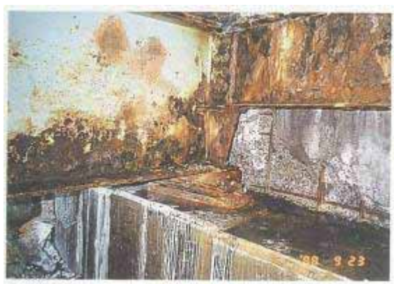
写真-1 桁端部における腐食 2)
