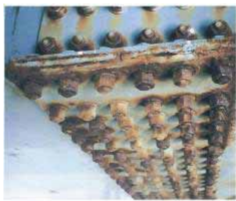
写真-2 現場継手部の腐食 2)
