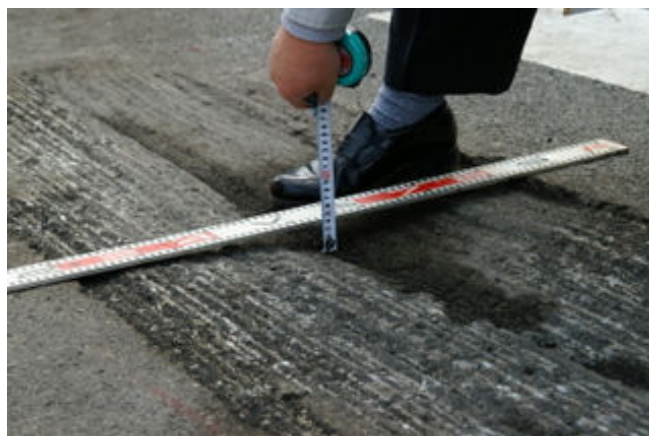
写真-2 模擬ポットホールの詳細
