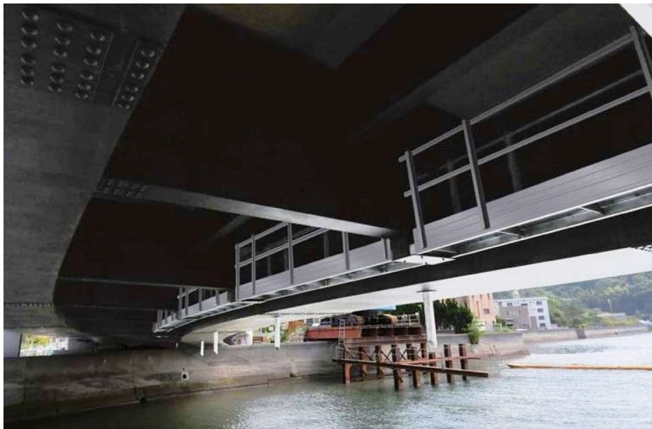
図 4. 3. 2. 3 海岸付近の架橋位置でアルミニウム製検査路を用いた例 (対策 4-30)
