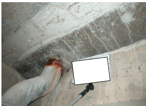
図 6. 3. 1. 3 排水桝付近の漏水例
