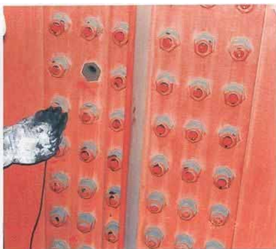
写真2.3.1-11 ボルトの破断
