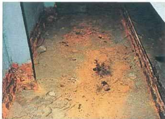
写真2.3.1-4 箱桁内部の腐食
