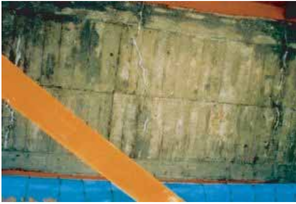
(a) 一方向ひび割れ
