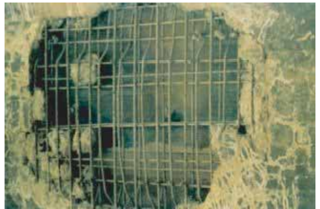
(d) 床版の陥没
