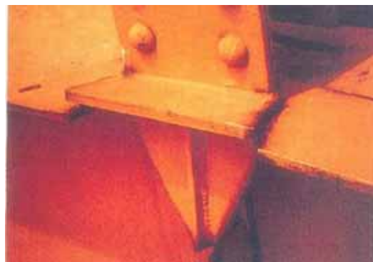
写真 2.3.1-8 アーチ橋の垂直材取付部の亀裂
