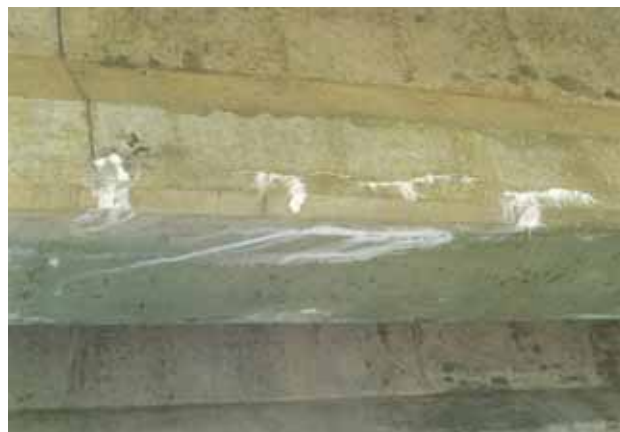
写真2.2.1-1 PCT桁の側面に発生したひび割れ
