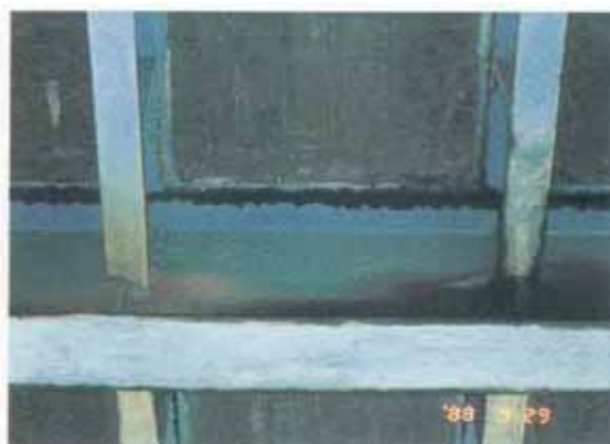
写真2.3.1-2 床版損傷部からの漏水による腐食
