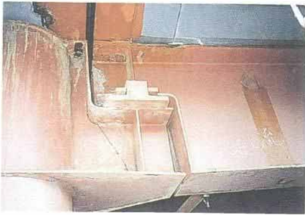
写真2.3.1-10 桁端切欠き部の亀裂
