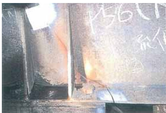
写真 2.3.1-7 支承ソールプレート溶接部付近の亀裂
