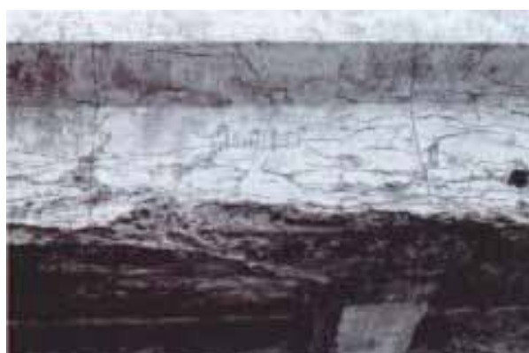
写真 2.1.1(5)-3 スケーリング（はく落）
