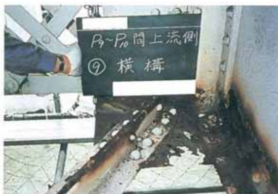
写真2.3.1-3 横構取合部の腐食
