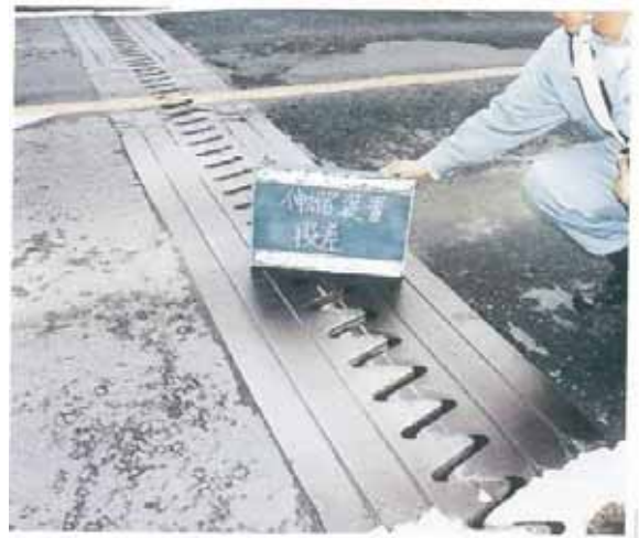
写真2.3.1-12 伸縮装置での段差
