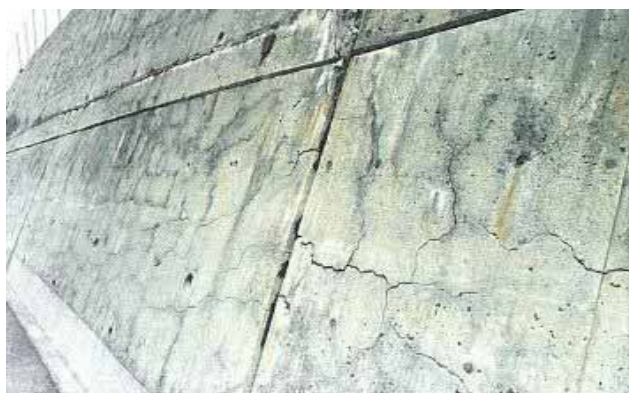
写真 2.1.1(2)-2 ASR による亀甲状ひび割れ発生状況
