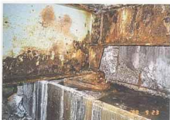
写真2.3.1-1 桁端部における腐食
