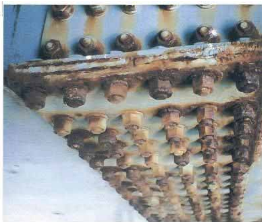
写真2.3.1-5 現場継手部の腐食
