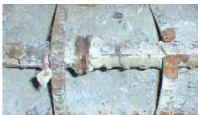
写真 2.1.1(2)-4 破断した鉄筋の例
