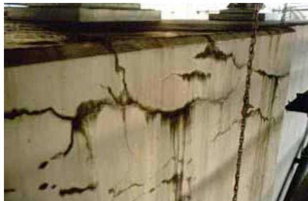
写真 2.1.1(2)-3 鉄筋破断した構造物のひび割れの例
