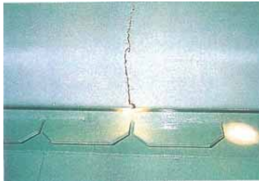
写真 2.3.1-9 縦リブ現場溶接部の亀裂
