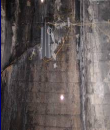
ひび割れ ①
