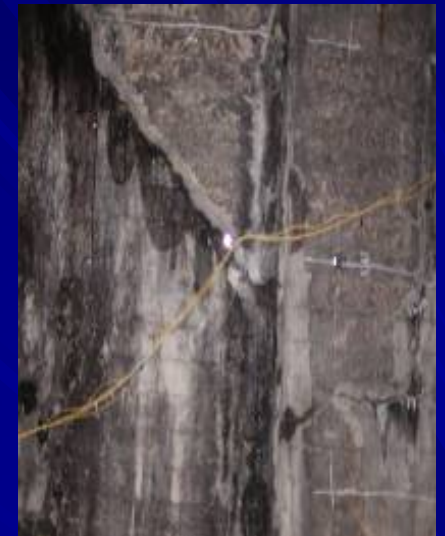
ひび割れ ④
