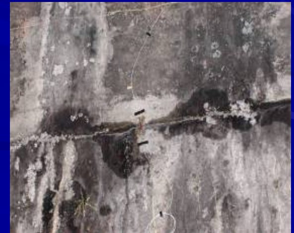
ひび割れ ⑨
