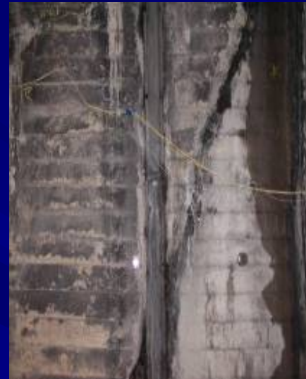
ひび割れ ③
