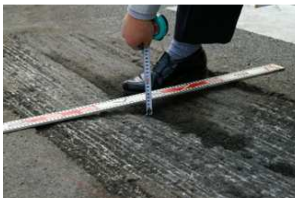
写真-2 模擬ポットホールの詳細
