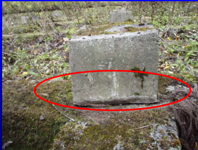
頭部コンクリートキャップの浮き
