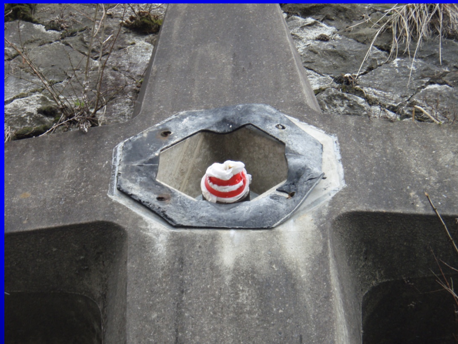
ゴムパッキンの劣化状況
