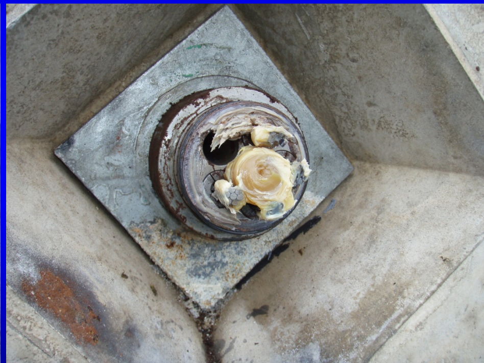
防錆油の充填が不足し ているもの
