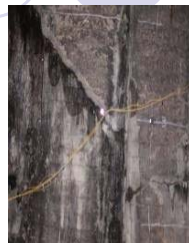
ひび割れ ④
