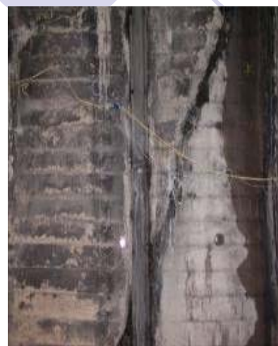
ひび割れ ③
