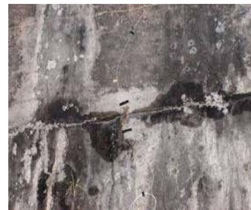
ひび割れ ⑨
