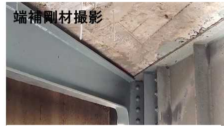
図-1 ドローンで撮影した鋭角側の補剛材撮
