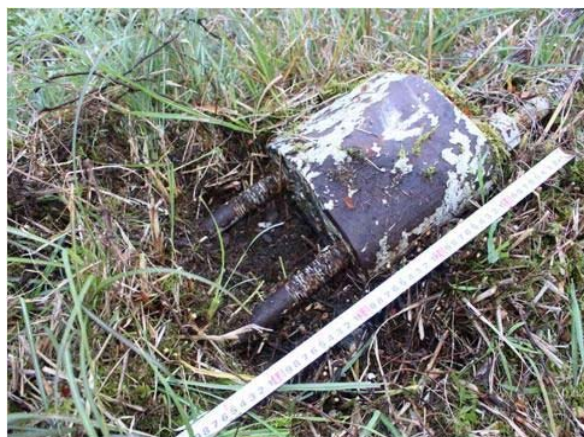
主ケーブルの腐食
