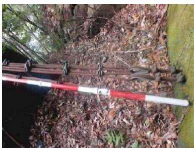
主ケーブル定着部の腐食④
