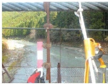
ハンガーケーブル定着部の腐食②
