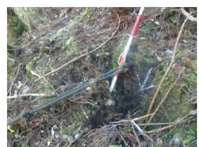
主ケーブル定着部の腐食⑥
