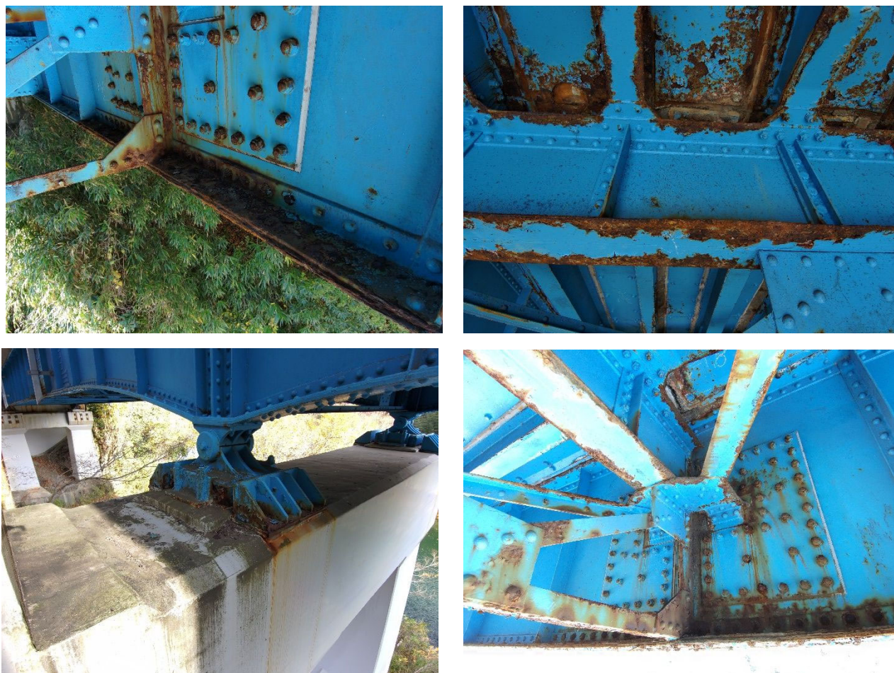
写真 2-7 ドローンを用いた損傷部の状況
