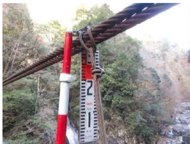
ハンガーケーブル定着部の腐食①
