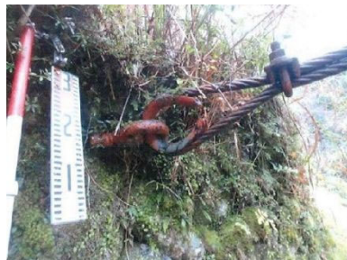
主ケーブル定着部の腐食①
