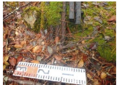
主ケーブル定着部の腐食③
