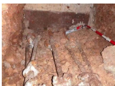
主ケーブル定着部の腐食⑤
