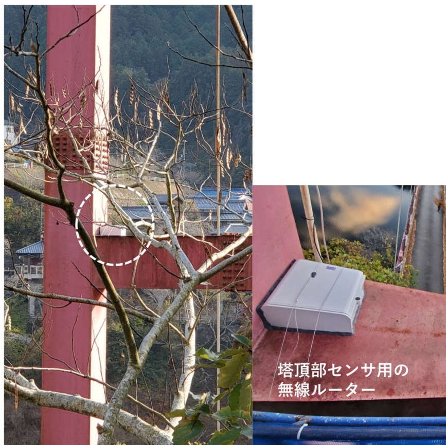
図 3-15 長期モニタリング用の無線ルーター設置状況（京都府側の塔）
