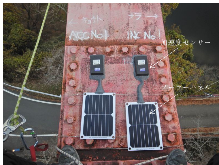
写真 2-8 モニタリングセンサー設置状況写真
