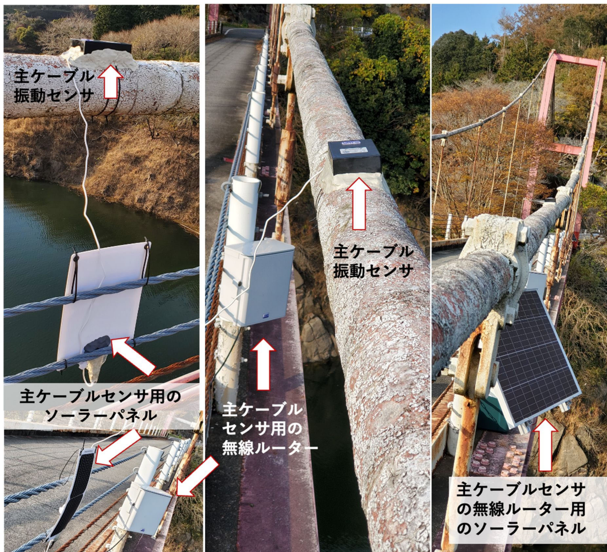
図 3-13 長期モニタリング用の主ケーブル振動センサ、ソーラーパネル、無線ルーター設置状況
