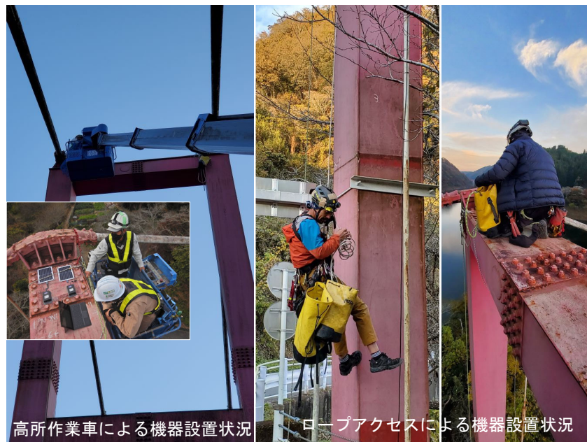
図 3-11 長期モニタリングのセンサと機器設置概要（京都府側の塔頂部）
