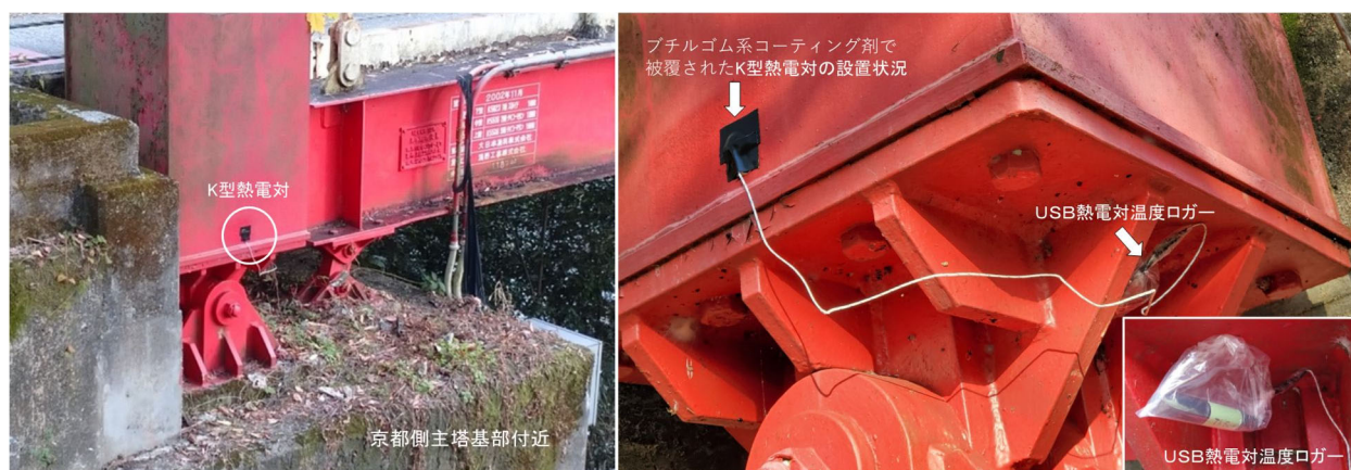
図 3-14 長期モニタリングの温度センサ設置状況（京都府側）
