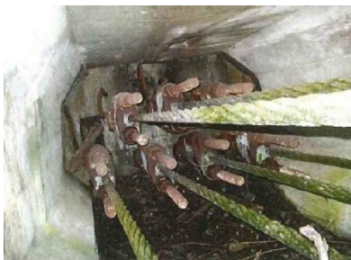
主ケーブル定着部の腐食②
