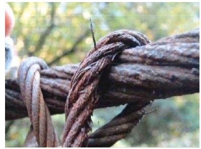
ハンガーケーブル定着部の腐食③
