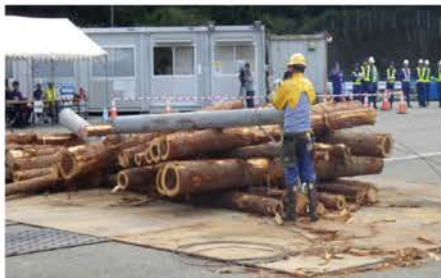
関西電力(株)による停電確認作業
