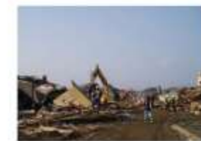
道路脇への山積による車線確保
