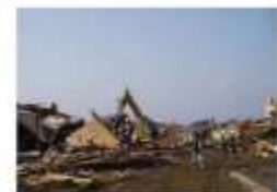
道路脇への山積による車線確保
