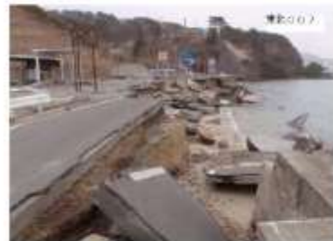
写真 海岸擁壁の破壊状況 (東日本大震災での被災事例)
