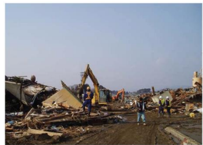
道路脇への山積による車線確保
