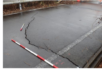
市道路面クラック
