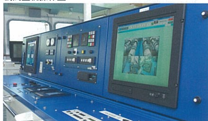
機関監視操作盤
