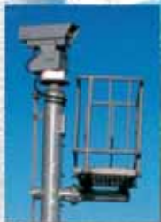
■ 河川・道路に設置されている監視カメラ(CCTV)の映像
