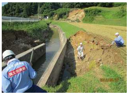
被災状況調査
