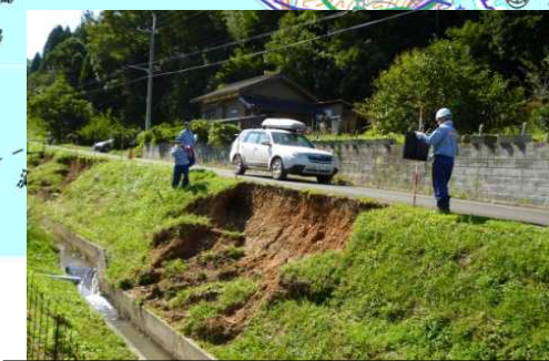
早期復旧に向けた状況把握 (綾部市滋賀郷地区)
