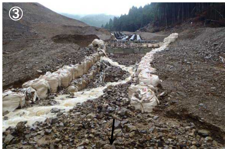
③ 河道閉塞土砂の斜面が侵食し、斜面上部に設置している排水パイプが一部損傷。
