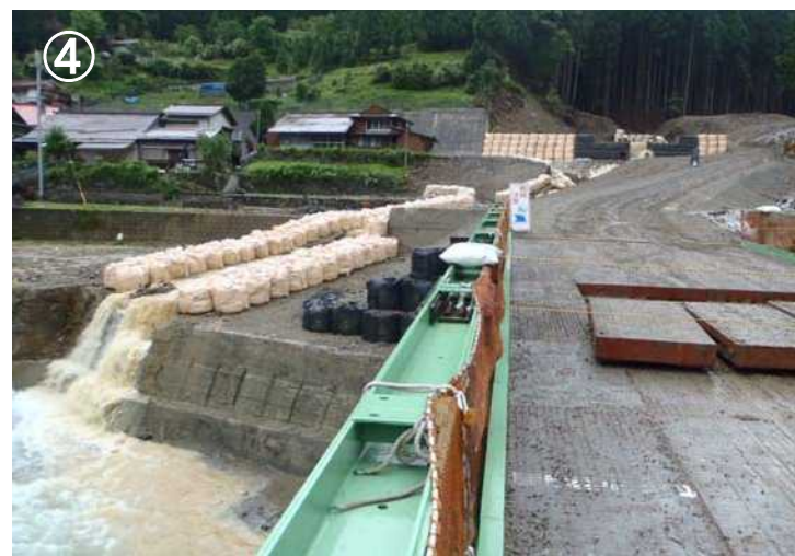
④ 下流部は水が安全に流下しており人家等に影響は出ていない。
