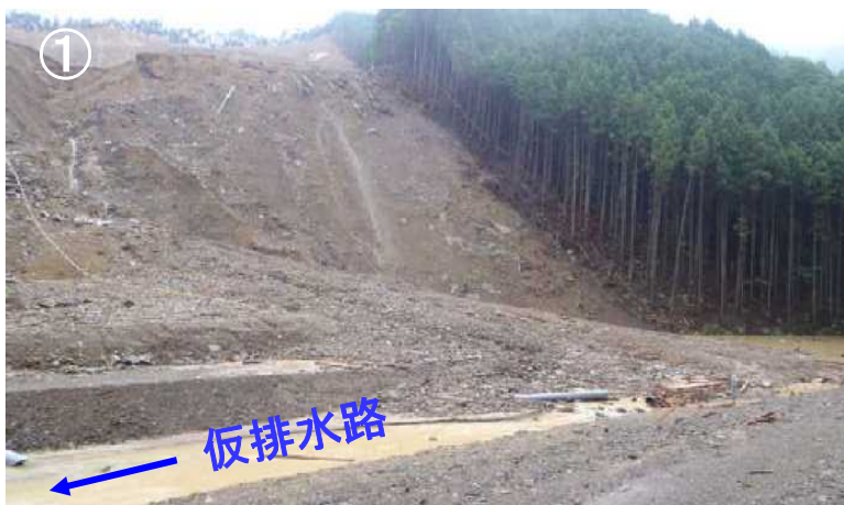
① 仮排水路の呑口付近の状況(土砂により一部埋塞)
