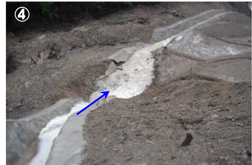
仮排水路のモルタル吹き付け、一部損傷 (仮排水路300mのモルタル吹き付けのうち150m)
