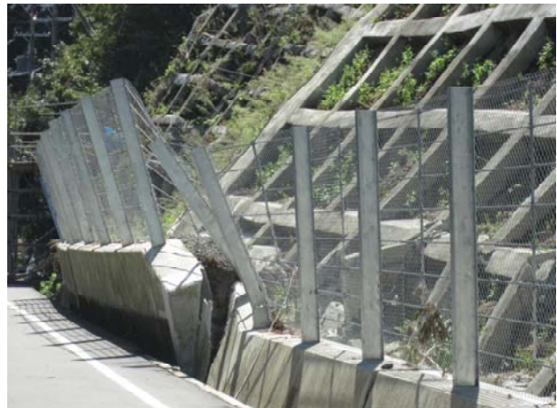
擁壁の損傷状況
