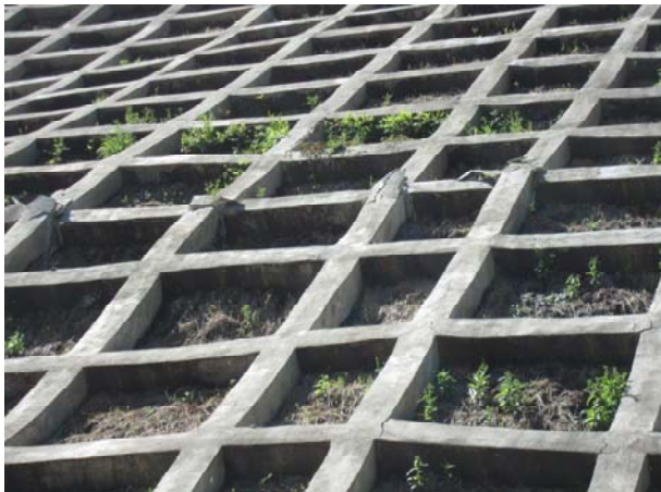
法枠コンクリートの損傷状況
