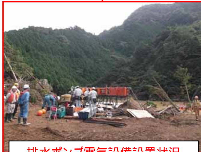
排水ポンプ電気設備設置状況
