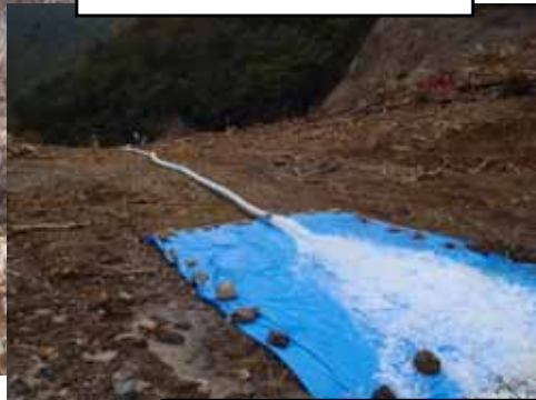
ポンプ排水状況
