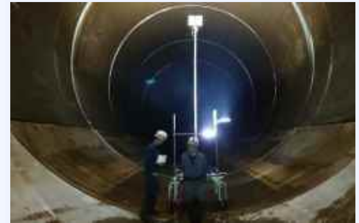
放流後の施設点検
