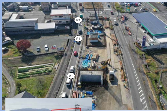
橋台・橋脚工事 上り線(京都方面)のA1橋台、P1、P2橋脚工事を行っています。
