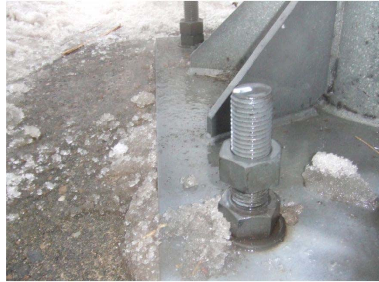
ボルトの緩み (施工不良)
