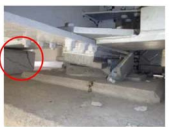
写真-6 支承の破損の状況
