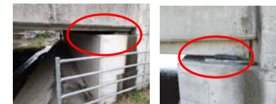
支承交換の作業空間なし
