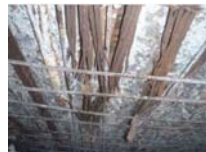
PC鋼材の腐食例
