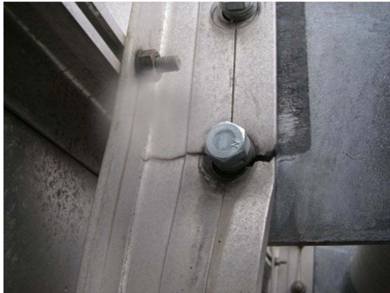
き裂損傷 (車両衝突)
