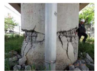
写真-7 段落し部の損傷 市道(1-3)中央線・中央線陸橋
