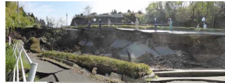
路面陥没地付近の状況 (4月15日)
