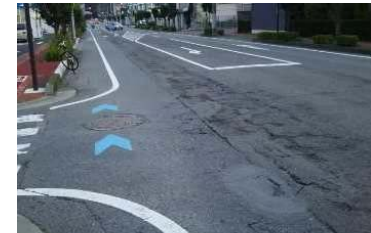
占用工事が起因する路面損傷
