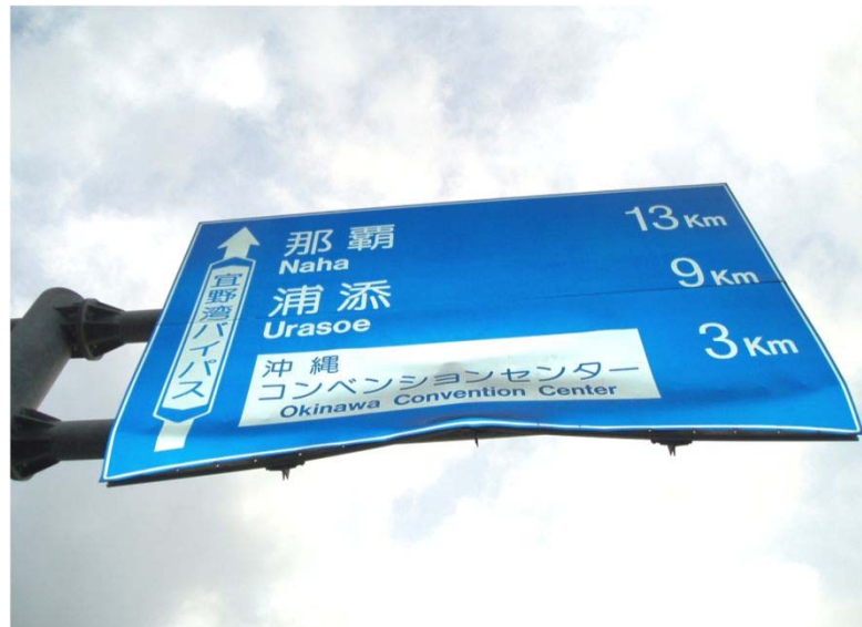
異常変形 (車両衝突)
