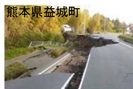
熊本県益城町 盛土の崩壊
