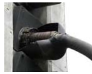
ケーブル損傷例
