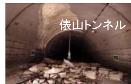
俵山トンネル 覆工コンクリートの崩落
