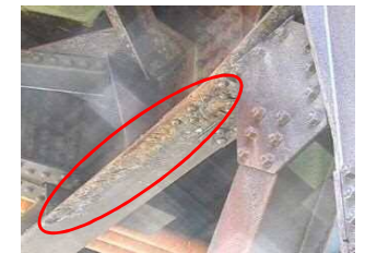
耐候性鋼材に層状の剥離
