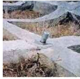
写真 受圧構造物の破損の例
