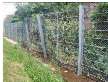
写真 落石防護柵の傾動の例
