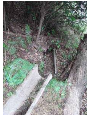
写真 排水溝の破損の例
