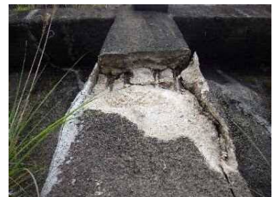
法枠工の老朽化損傷
