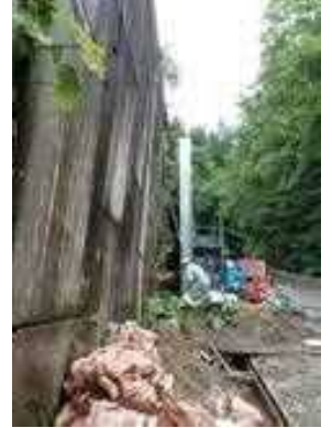
写真 壁面の傾斜の例
