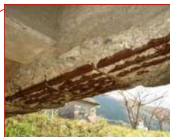
主桁の剥離、鉄筋露出
