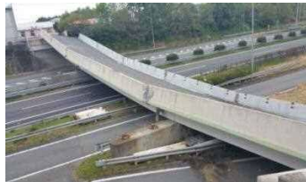
ロッキング橋脚を有する橋の落橋
