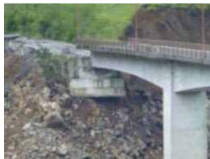
斜面変状による橋台の沈下
