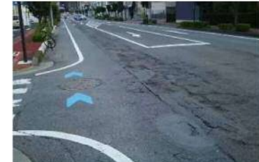
占用工事が起因する路面損傷
