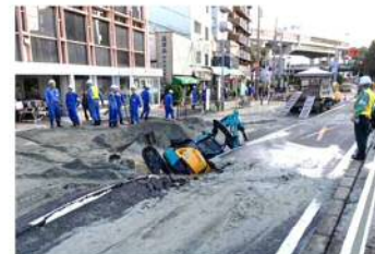
埋設管の老朽化に伴う道路陥没
